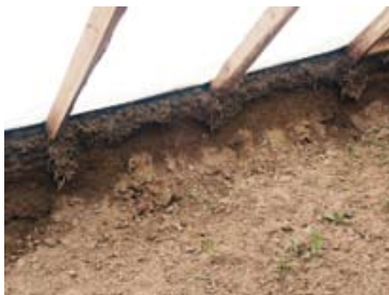
Фото 44 - Растрескивание земли в результате размещения балок непосредственно на грунте
