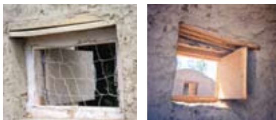
Фото 28 и 29 - Установленное боковое вентиляционное отверстие, затянутое проволочной сеткой
