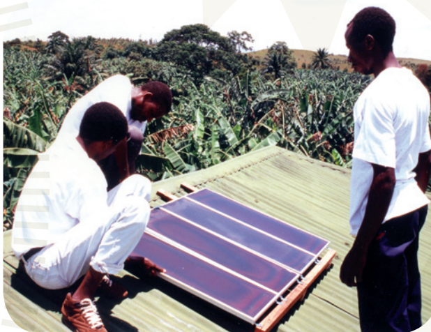
Panneau PV sur toiture
